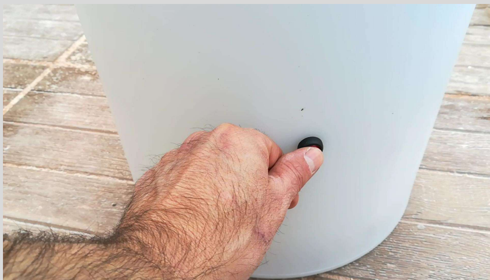
Ilustración 2. Estado Manual ON/OFF para la bomba soplante
