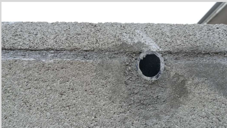
Ilustración 4. Tubo para aspiración de aire nuevo
